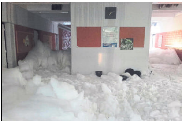
Knietief versank der naturwissenschaftliche Trakt nach dem Feuerwehreinsatz am 29. August 2016 im Löschschaum. Der Brand richtete einen Schaden von zwei Millionen Euro an.
